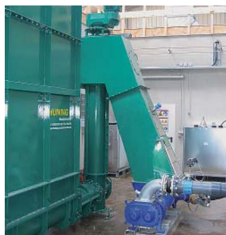
Передача от дозатора твердых материалов в насосные системы
